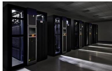
MANTENIMIENTO PREVENTIVO Y CORRECTIVO A SITIOS DE TELECOMUNICACIONES
